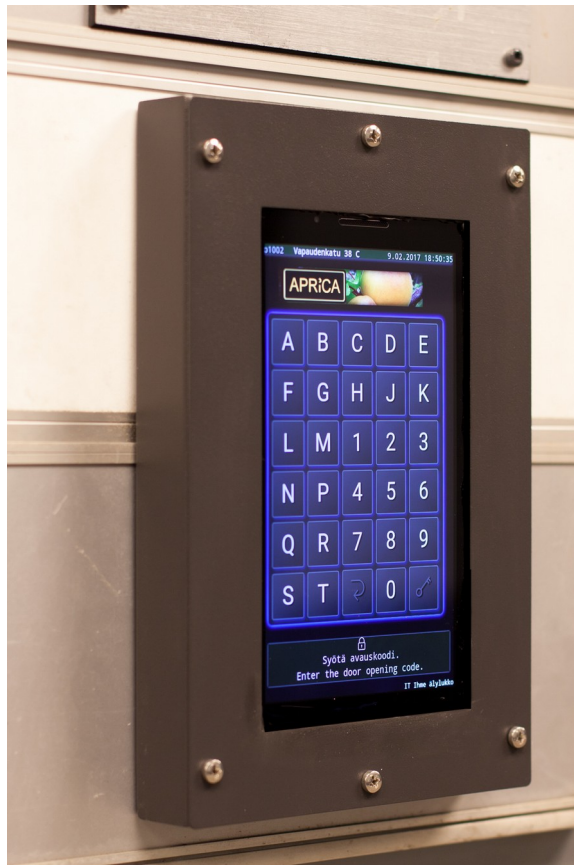
Asennus kohteessa Vapaudenkatu 38, Jyväskylä. Asiakkaan omalla logolla.
